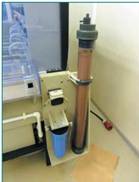
Рис. 2. Ионообменная колонка, снабженная устройством для фильтрации
