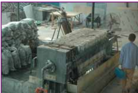
Рис. 5. Одна из установок водоочистки
