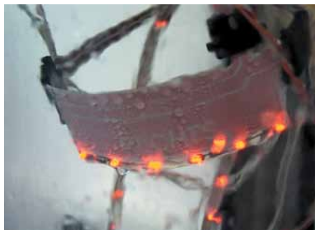
Рис. 3. Пример электронного узла в условиях конденсации при 40 °С/100% (источник: Lackwerke Peters GmbH + Co KG)
